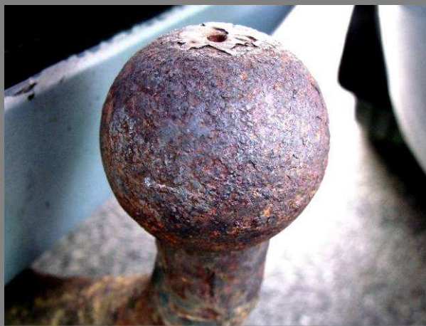
Obr. D9 – detail zkorodované hlavice
