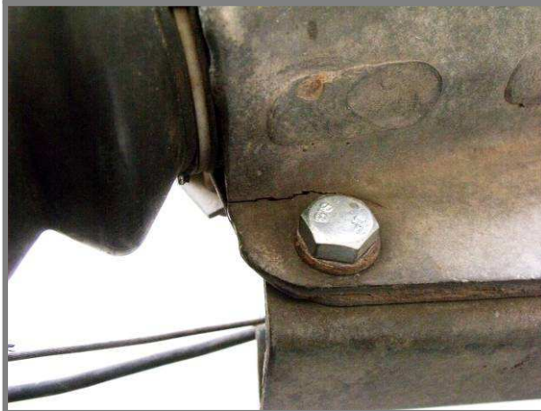
Obr. C43 – Prasklina v těle nájezdové brzdy
