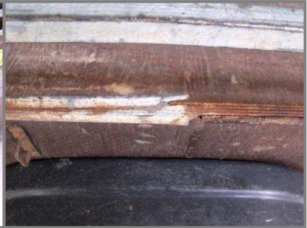
Obr. C34 – Detail poškozené kovové hrany
